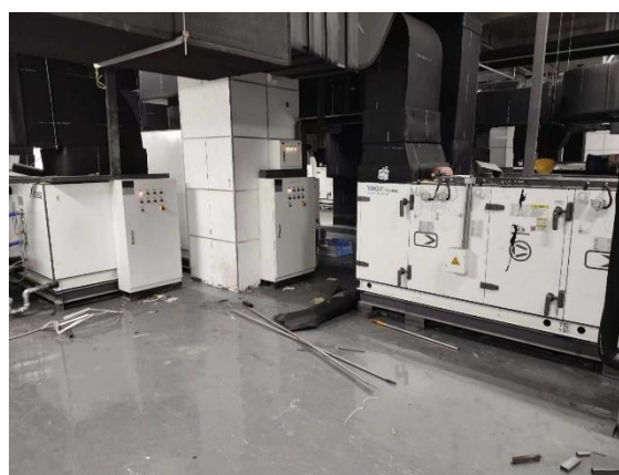
机房上方净化机房
